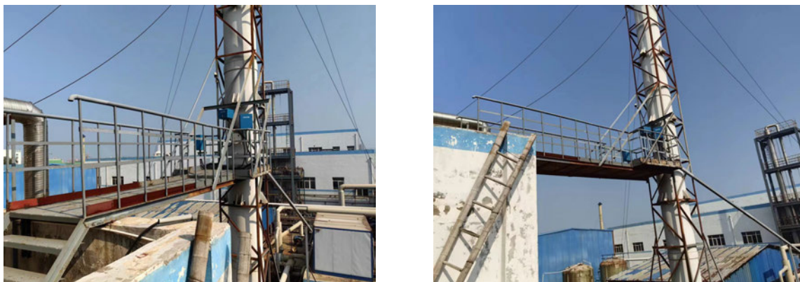
废气监测平台、监测口
