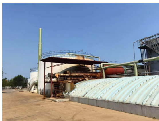
污水处理站排气筒 P5(15m)
