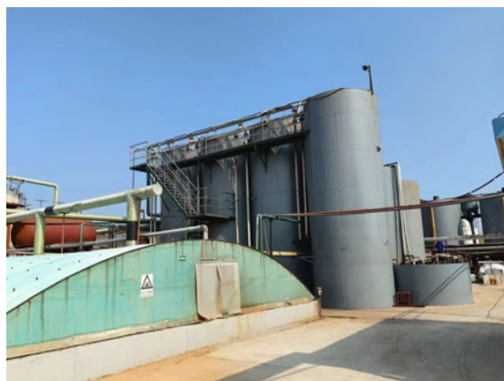
污水处理装置
